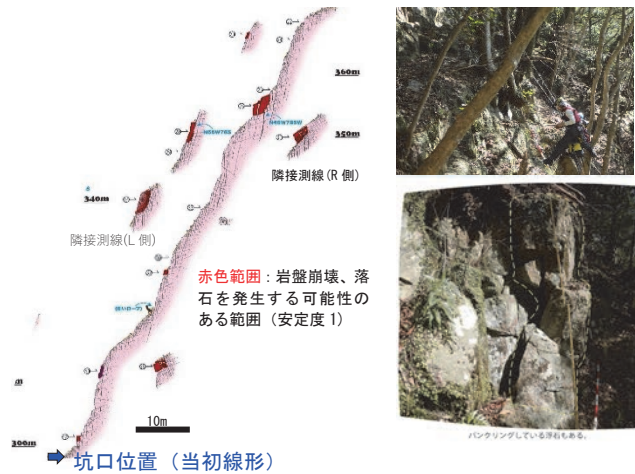
図 6 坑口斜面上の不安定岩塊(クライミング調査)
