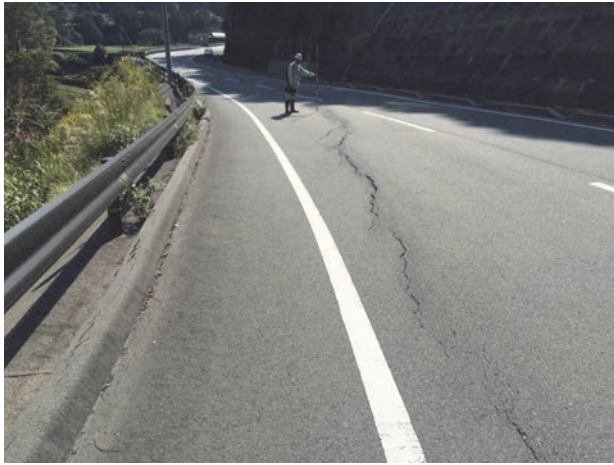
道路面のクラック状況
