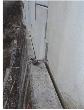
テールアルメ末端付近の変状
