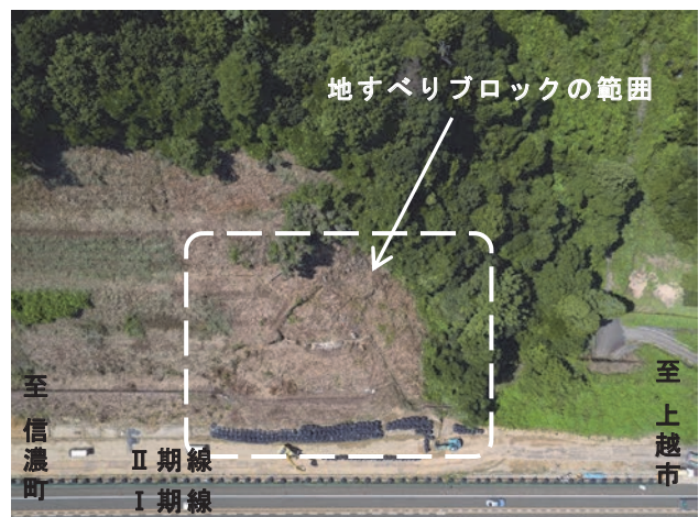
図2 切土のり面の地すべりブロック全景
