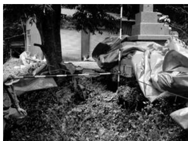
地すべりブロック頭部の滑落
