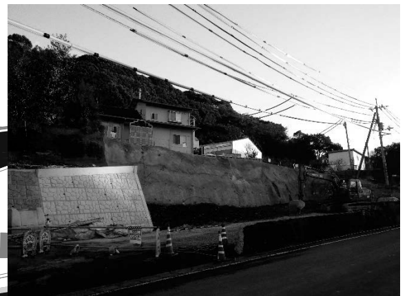
写真-1 被災斜面全景
