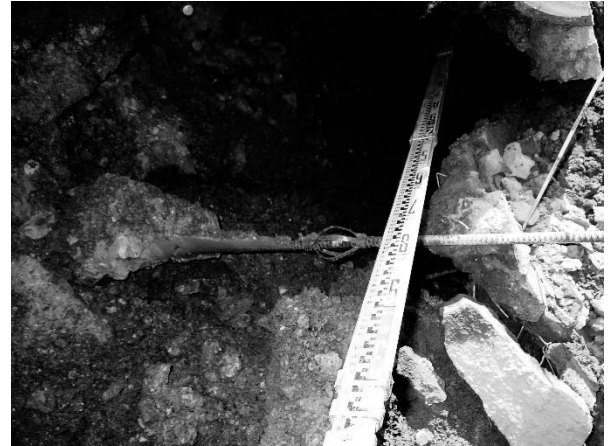
写真-3 鉄筋挿入工部の中抜け被災 実施し、変位抑制後に追加の地盤調査（調査ボーリング・大型動的コーン貫入試験）を実施した。
