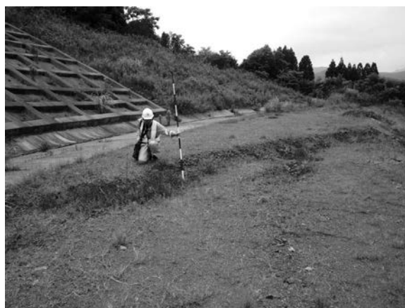
写 3. 掘削エリアに発生した段差
