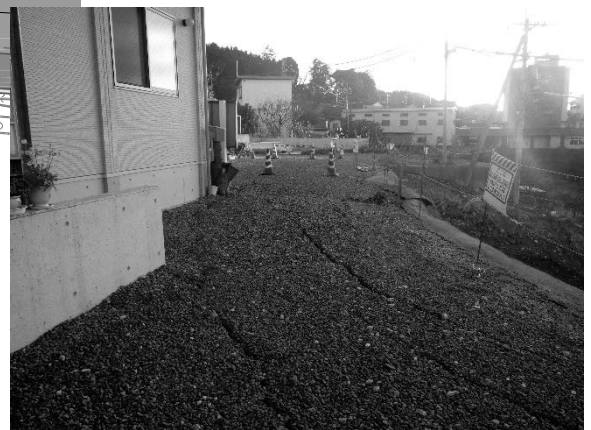
写真-2 敷地変状状況
