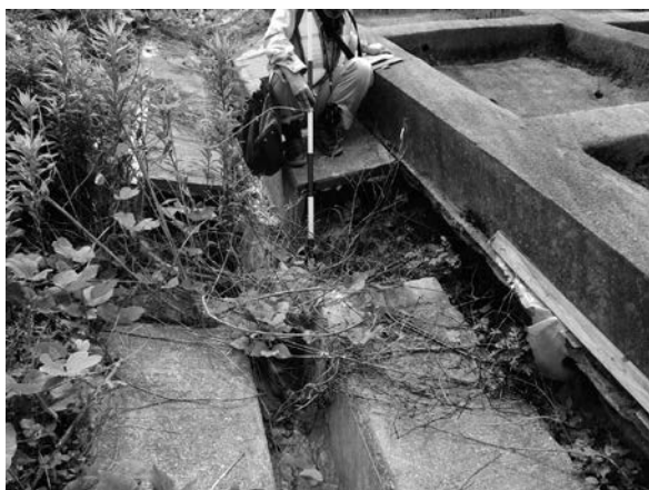
写 4. 法枠及び水路の変状
