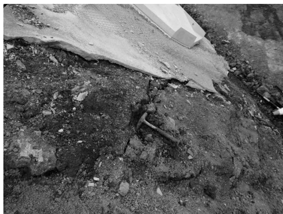
写 5. 掘削法面の状況（含水による軟弱化）
