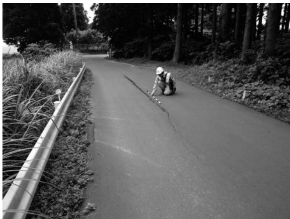
写 2. 排土法面背後の路面に発生した亀裂
