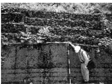
左側方部のクラック
