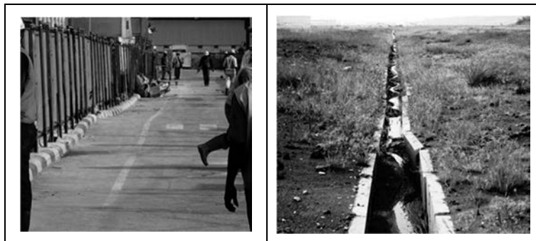
図 6 道路の浮き上がり（左）、用水路のはらみ出し（右）
