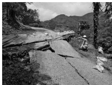
右側方部のクラック・沈下
