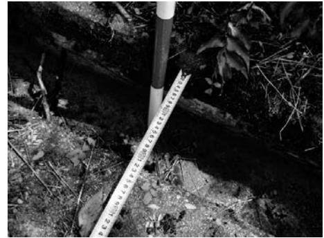
写真 1 押出により U 字溝が潰れている。 押出による変位約 10cm 亀裂面は古い箇所が多い
