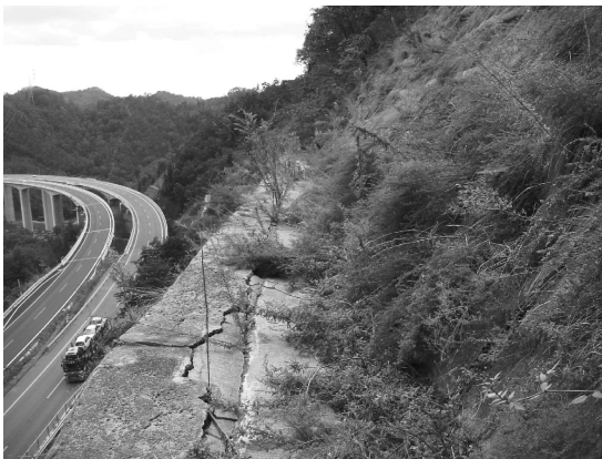
写 2. 小段に発生したクラック
