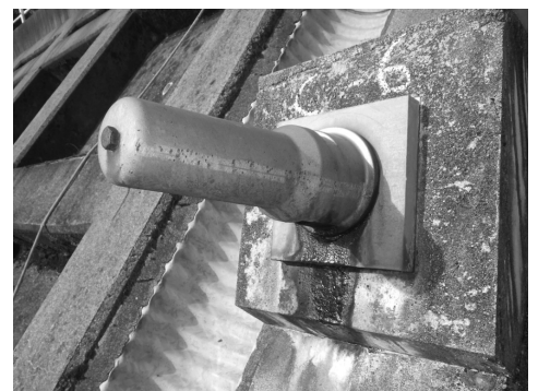
写真2 アンカー頭部の浮きと防錆油の流出
