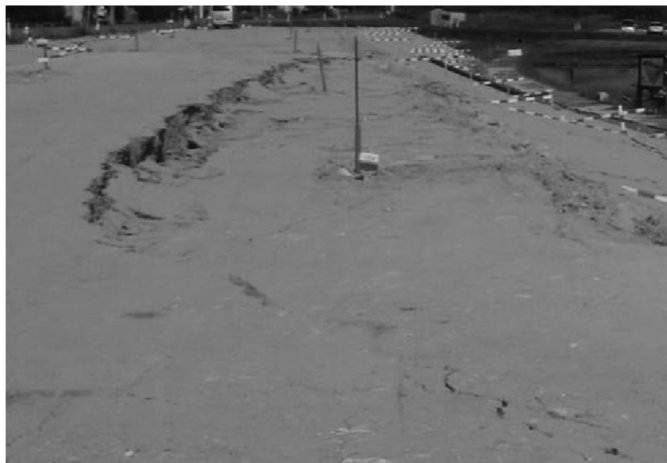
写真1 類似地盤でのすべり破壊事例
