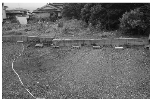
図 4 法面上方の民地に発生した滑落崖の全景(破線) 手前の駐車スペースは、この後、使用不能となる。
