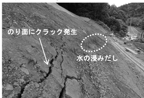
写真2 切土法面に発生した変状
