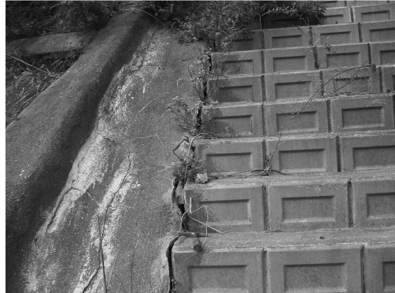
写 3. 管理用階段に発生したクラック
