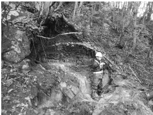
写5 落石の発生源 (抜け落ち跡)
