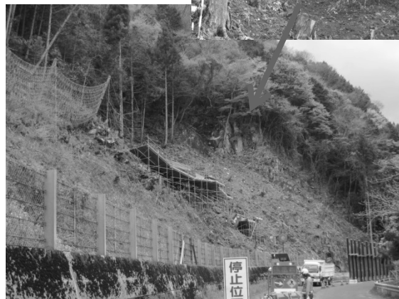
写1 対象斜面の状況と緩み岩盤の崖面
