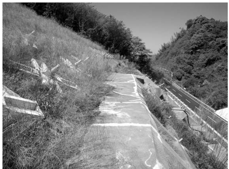
約 40m, 長さ約 50m 規模の岩盤地すべりが発生 図 2. 変状履歴のあるアンカーのり面状況
