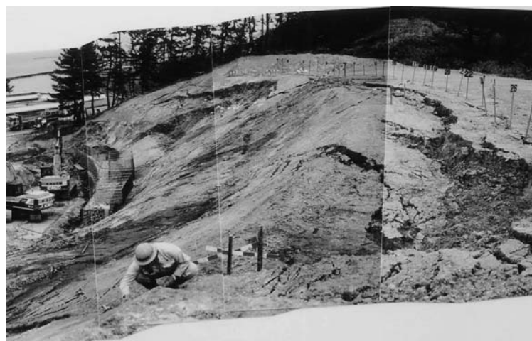
図2 斜面末端部でもっとも切土量が多い部分における、切土のり面の変形状況(右上に見える列状の細い棒は杭の施工位置を示す)
