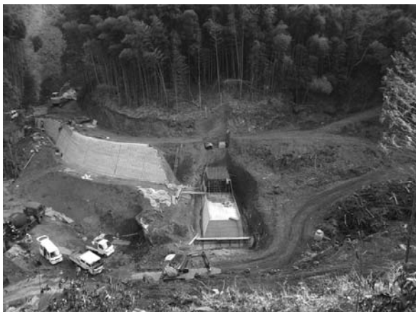
写真 1 砂防ダム軸で出現した破裂帯
