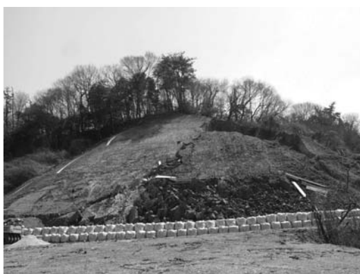
図1 切土法面全景（崩壊直後）
