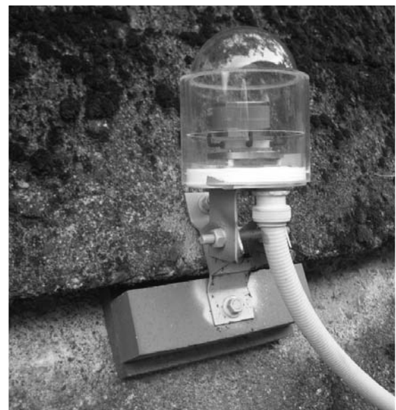
図4 傾斜検知器設置部の拡大
